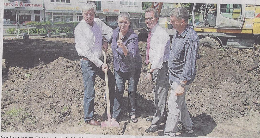
Gestern beim Spatenstich (v.l.): Elmar Schnöckelborg und Carla Kaiser (beide Bürgergesellschaft Bismarckplatz), OB Gregor Kathstede und Norbert Mosters (Grünflächenamt). Foto: jps
